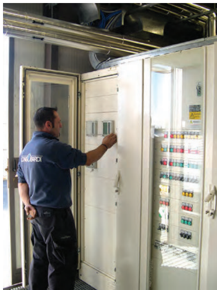
La Longobardi offre tutti i servizi legati alla climatizzazione degli edifici, grandi o piccoli che siano.
